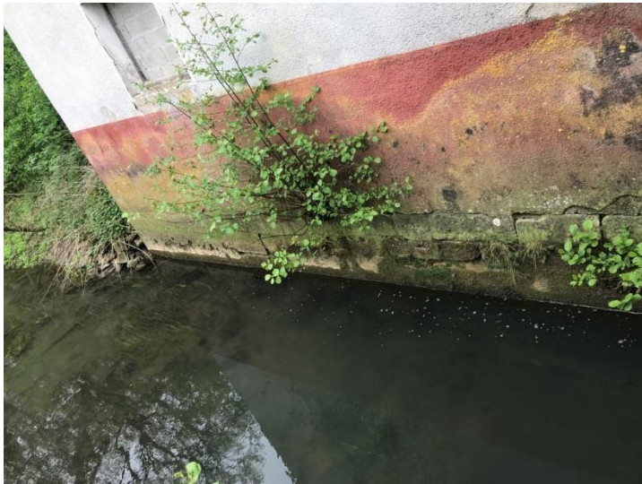
Façade nord est en contact avec l'eau du ruisseau
